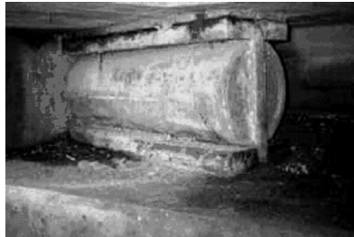
Rollenlager einer Brücke mit beginnender Korrosion
